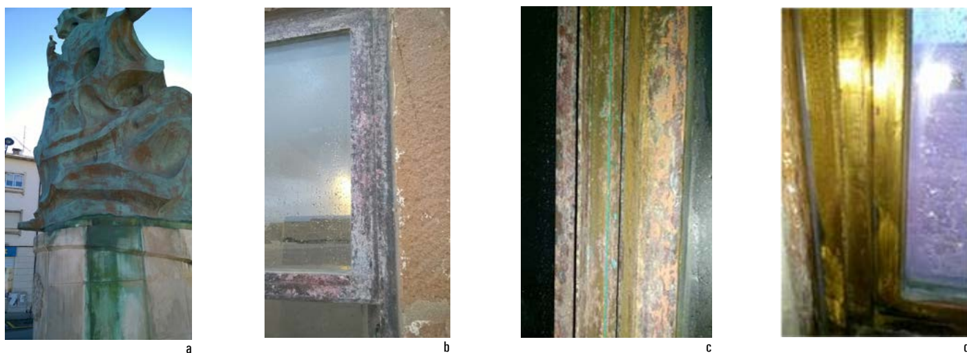
Figura 15 Morfologia e aspeto típico das pátinas do cobre e ligas (em cima). Exemplos de formas de corrosão ativa em ligas de cobre: a. Dissolução de pátinas; b. Deszincificação em caixilharia de latão; c. Detalhe do lado exterior; d. Detalhe do lado interior. Fotografias da autora.
