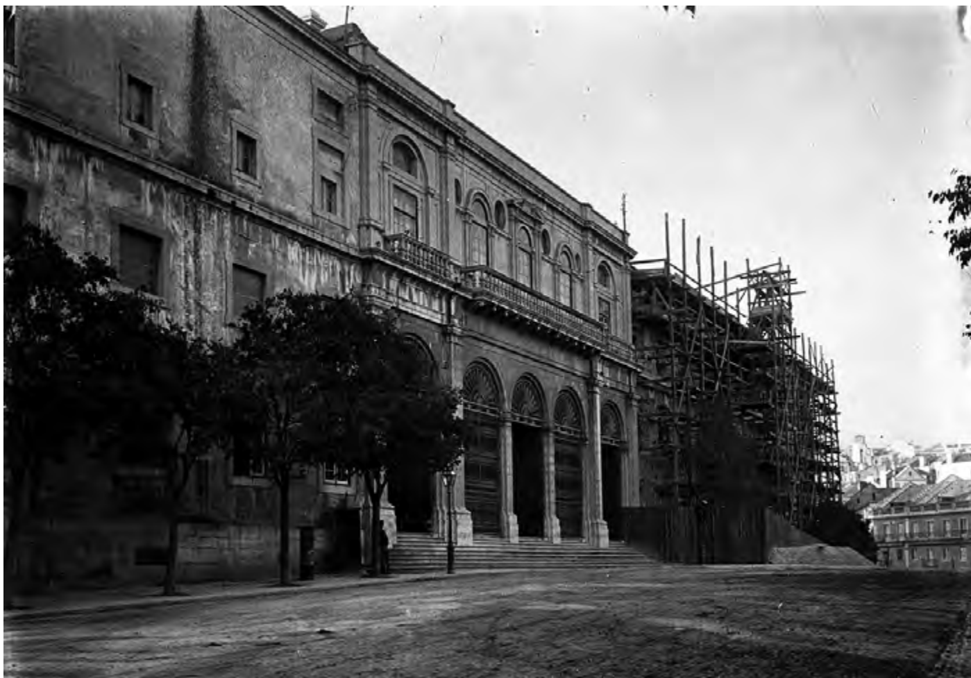
Figura 6 Palácio de São Bento, antes das obras de restauro de Ventura Terra, Joshua Benoiel, [ant. 1903]. Arquivo Municipal de Lisboa, PT/AMLSB/CMLSBAH/PCSP/004/JBN/000339.
