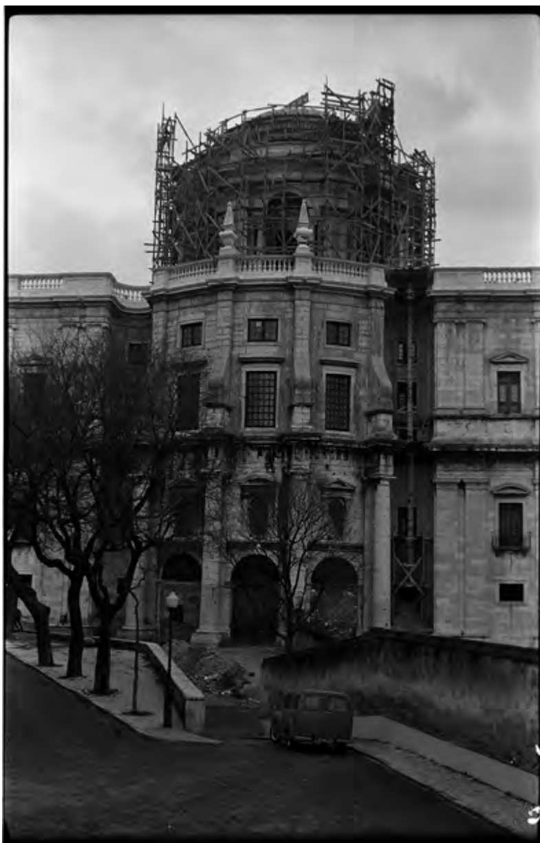
Figura 11 Igreja de Santa Engrácia em obras, Casa Fotográfica Garcia Nunes, 1966. Arquivo Municipal de Lisboa, PT/AMLSB/CMLSB/PCSP/004/NUN/001929.
