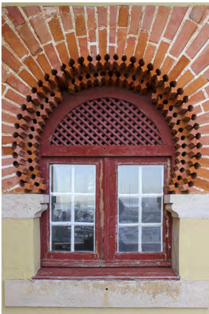
Figura 5 Casa de Santa Maria, arco de tijolo polilobado de uma janela do segundo piso. Fotografia dos autores, 2018.
