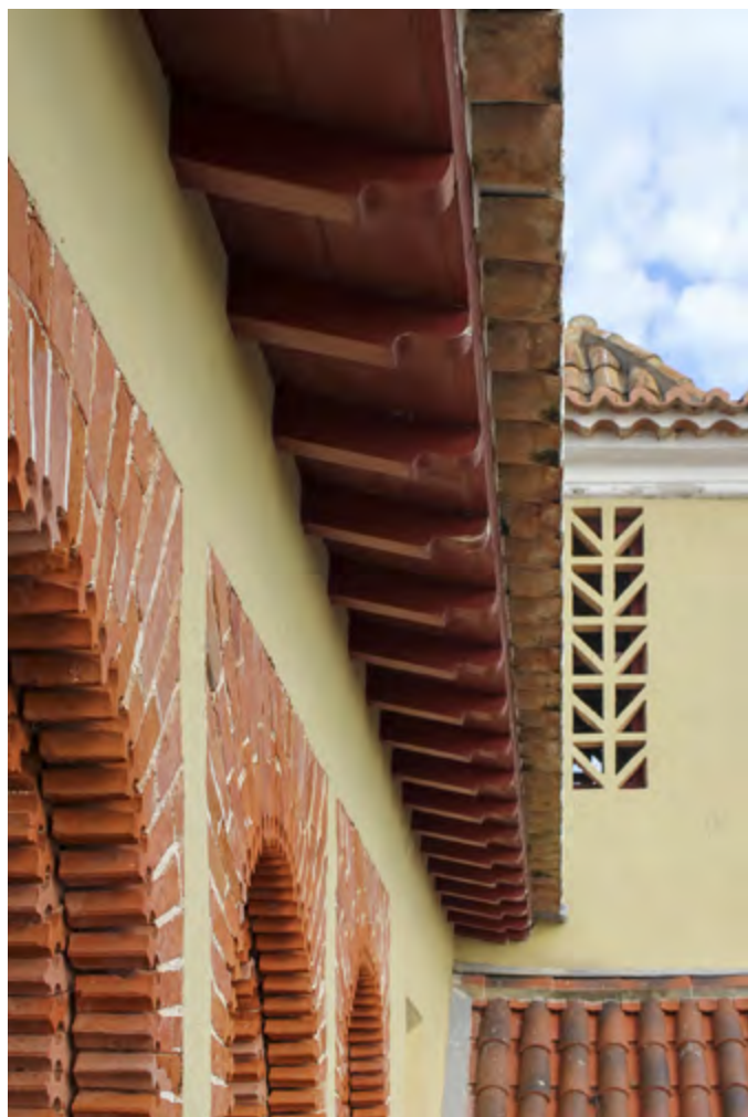
Figura 6 Casa de Santa Maria, pormenor do beirado do telhado. Fotografia dos autores, 2018.
