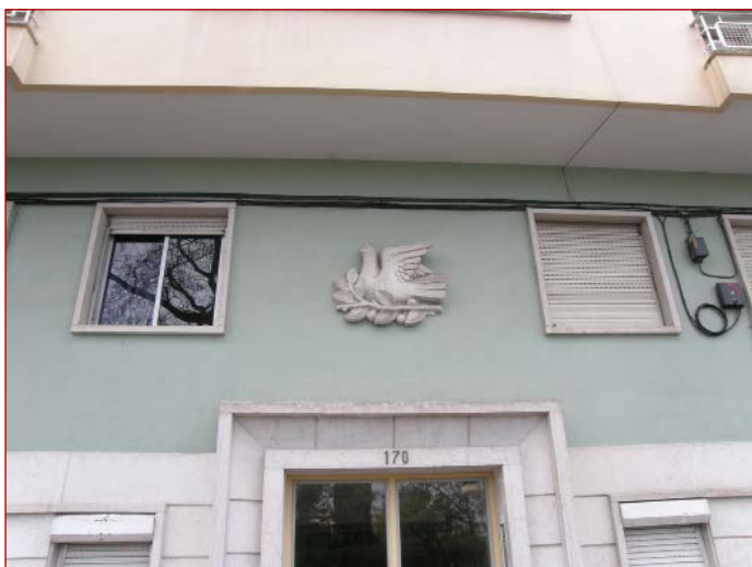
Figura 8 “Entalado” de José Farinha em edifício da avenida do Brasil, n.º 170 (arq. Sérgio Botelho de Andrade Gomes), c.1956. Fotografia da autora.
